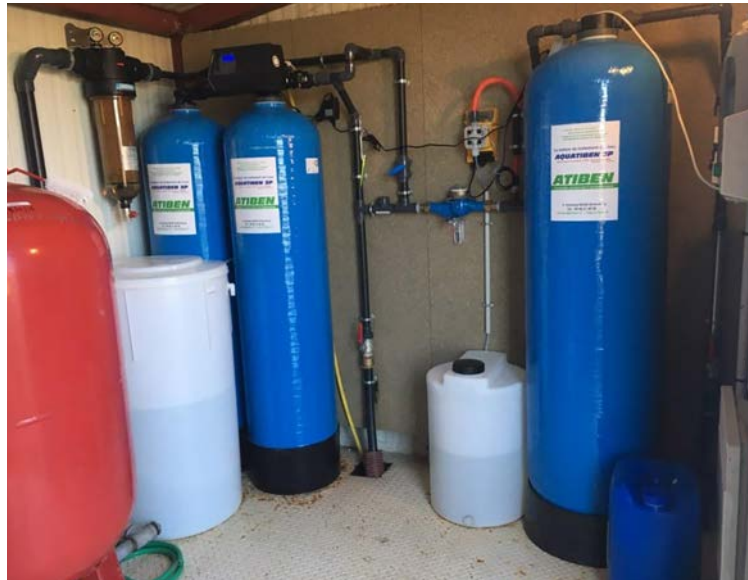
• L'eau, une fois nettoyée et déminéralisée, peut être stockée indéfiniment dans une cuve en composants synthétiques à l'abri du soleil.
